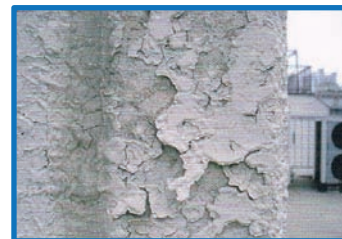
吹き付けのはがれ
