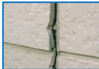
サイディングの割れ
