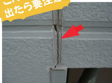
コーキングの劣化
