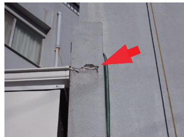
外壁面の爆裂
