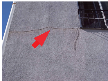
外壁のクラック
