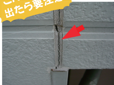
コーキングの劣化
