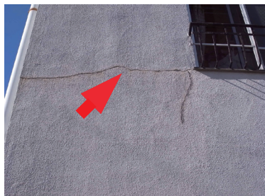
外壁のクラック
